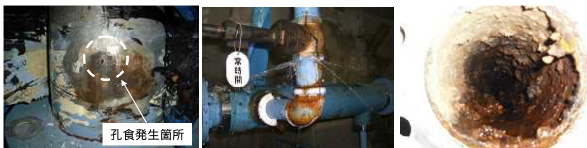
図-1 再利用水配管で漏水や閉塞が発生した様子
