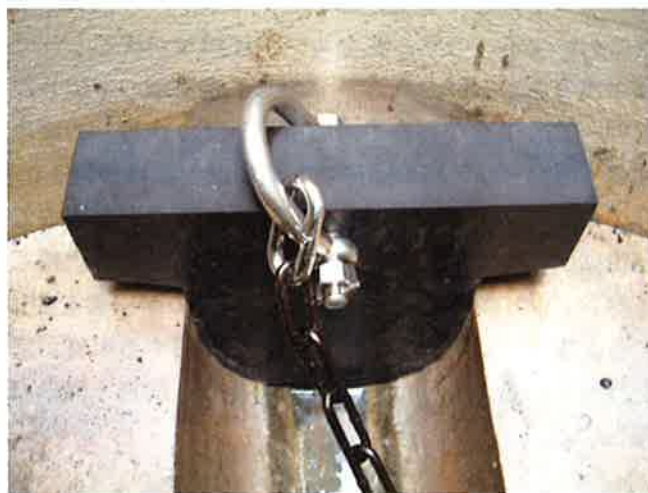
写真－1 フラッシングゲート
