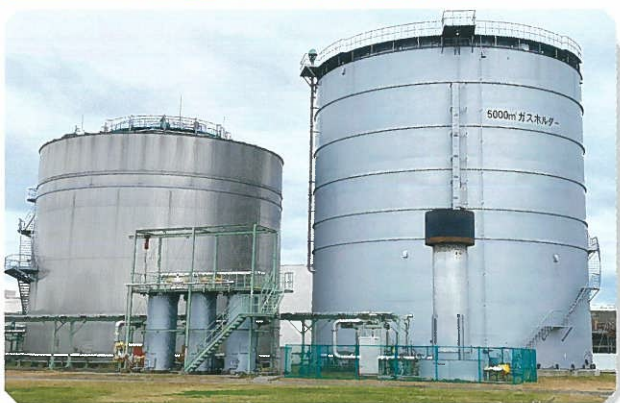
汚泥消化タンク
