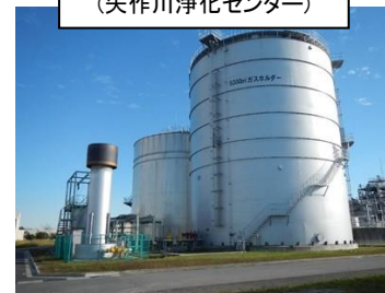
下水汚泥メタン発酵施設 (矢作川浄化センター)
