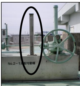
図-5 開度目盛設置場所
