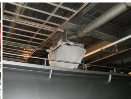
図-3 集塵ダクト変更後
